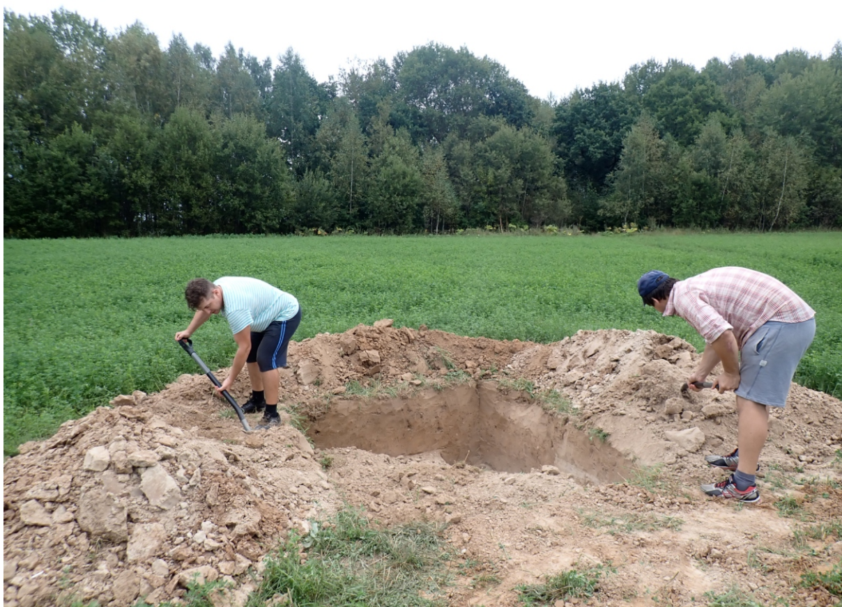
Илл. 12. Калужская область. Ферзиковский район. С. Авчурино. 2021 год. Процесс работ. Рекультивация шурфа, вид с ЮЮЗ.
